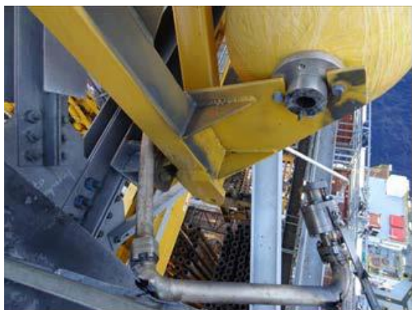
CAPV y tubería de interconexión que fallaron
