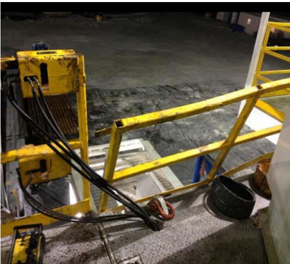
Daños al pasamanos
